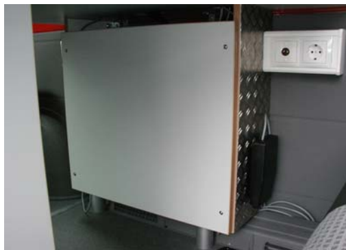
Technikschrank: mit abnehmbarer Frontplatte zur Aufnahme von Funk S/E-Geräten und Batterieladegerät
